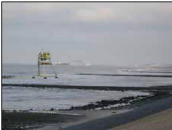
De WESP in volle actie met op de achtergrond een sleephopperzuiger die bezig is te 'rainbowen', zand opspuiten voor de kust.
