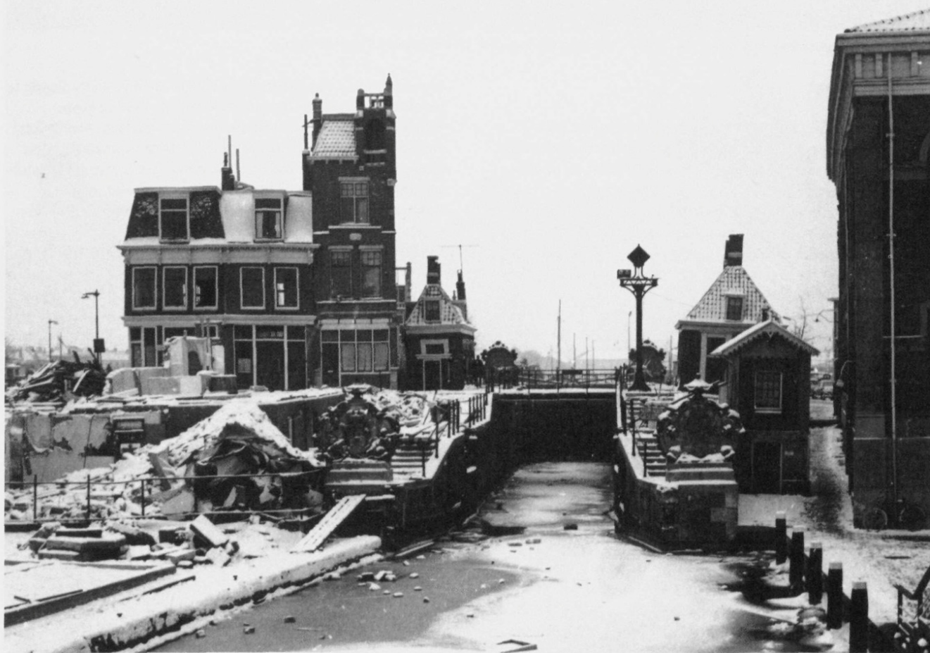
De sluis tijdens de sloopwerkzaamheden voorafgaande aan de bouw van het Zaangemaal, begin jaren zestig. Op de voorgrond de gedenksteden van het Hoogheemraadschap van de Uitwaterende Sluizen afkomstig van de oude Duikersluis. Het wachthuisje rechts verdween naderhand ook.
